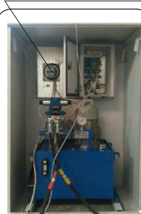
Фото гидростанции блокиратора с блоком управления
