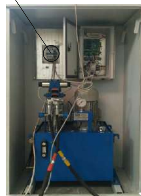
Фото гидростанции блокиратора с блоком управления
